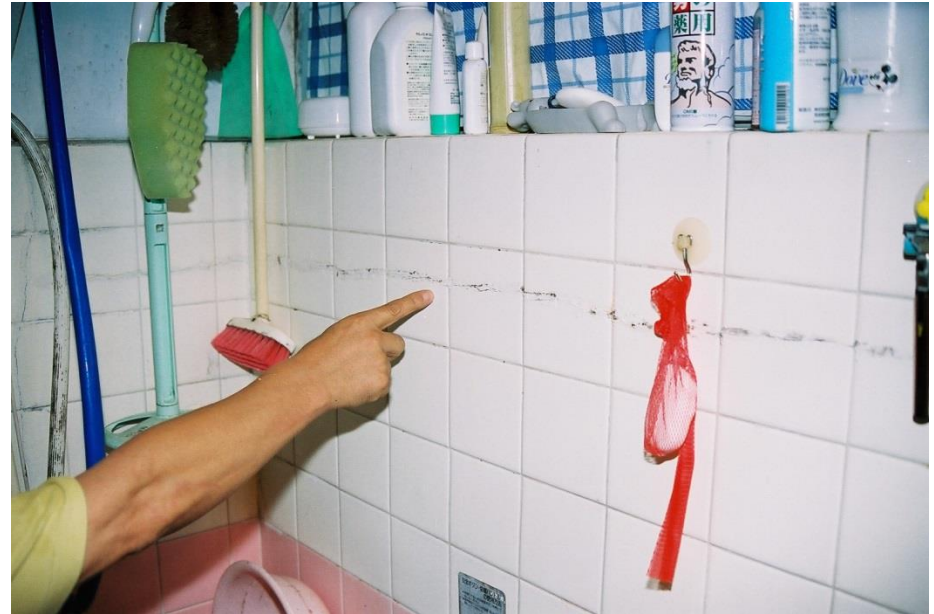
タイルのクラック
