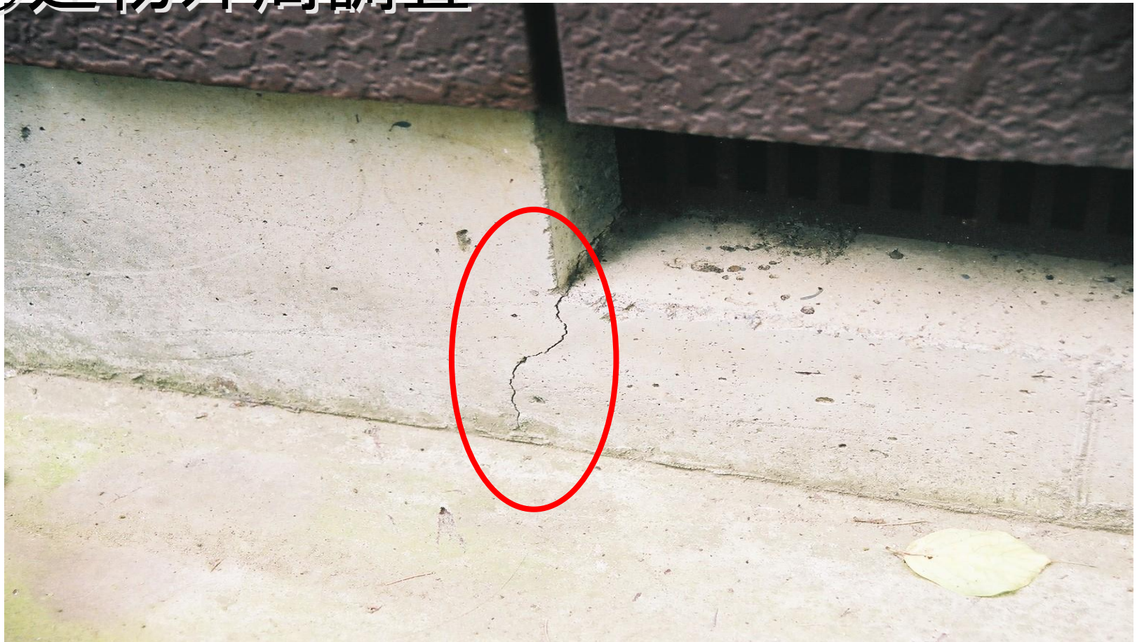
基礎のクラック
