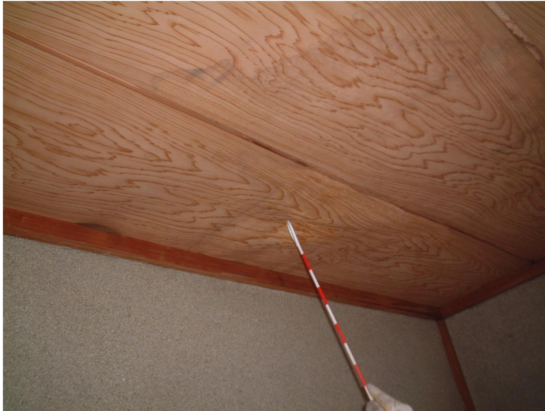
雨漏れの様子
